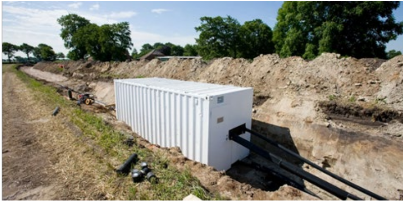
Abbildung 32: Beispiel für Muffengruben und -container
