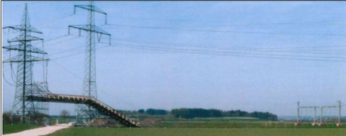
Abbildung 15: Kabelbrücken im Bereich der Provisorien zur Querung von Straßen
