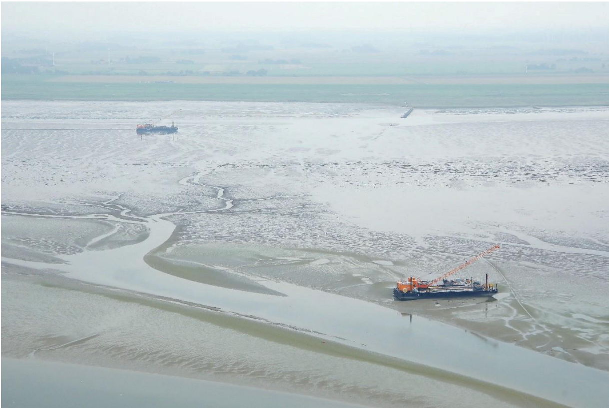
Abbildung 15: Luftbild einer exemplarischen Wasserbaustelle bei Hilgenriedersiel mit dem Arbeitsponton am Bohraustrittspunkt im Hintergrund und dem Anlege- und Fährponton am Riffgat- Fahrwasser im Vordergrund (Quelle: TenneT)
