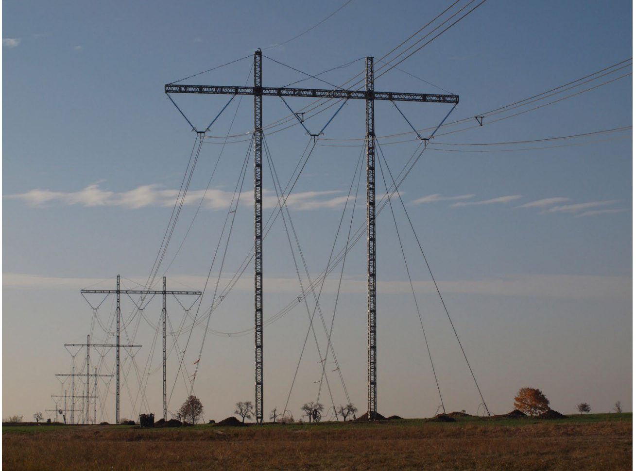
Abbildung 7: Beispiel für ein 380-kV-Freileitungsprovisorium (Quelle: SAG)
